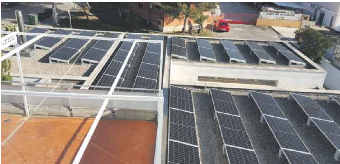
Instalación fotovoltaica en la guardería de Fuente del Jarro
