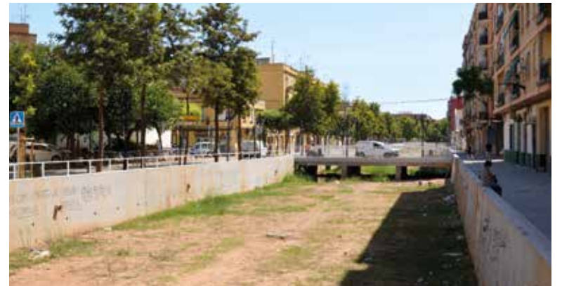
Barranc La Saleta a Aldaia
